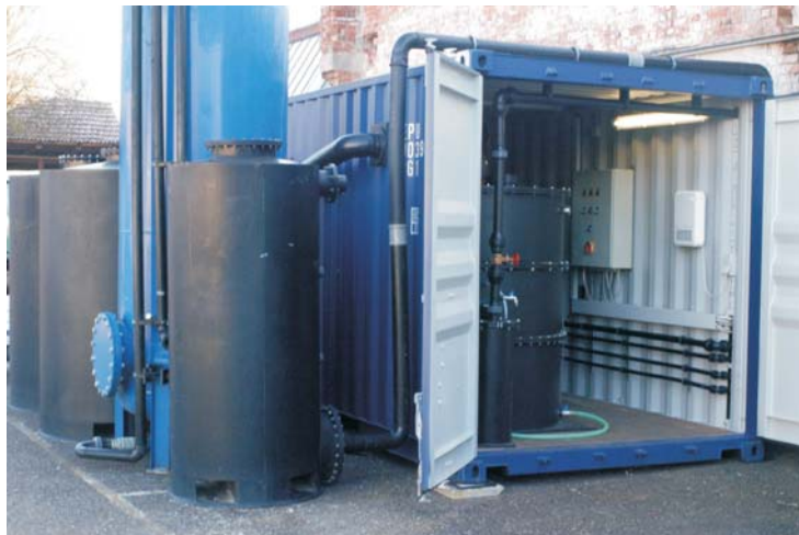
Kompakt-Strippanlage in Containerbauweise mit Aktivkohlefilter
