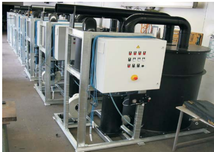
Kompakt-Strippanlage auf Stahlrahmen montiert
