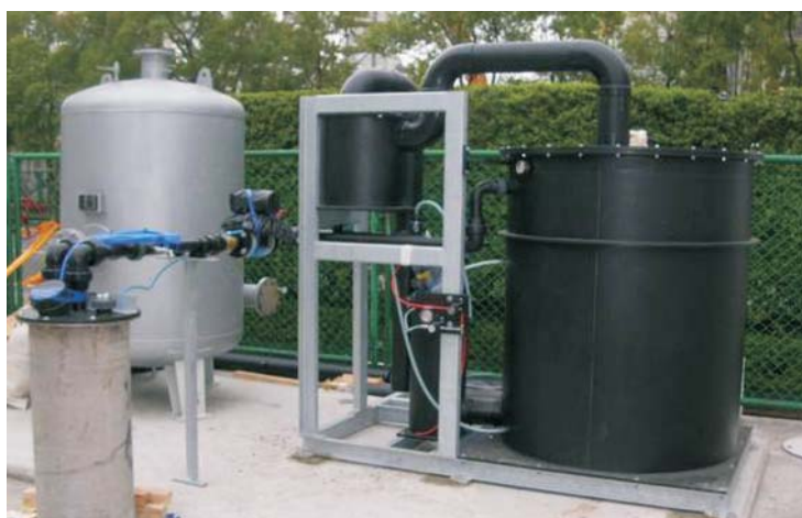
Kompakt-Strippanlage mit Grundwasser-Zirkulations System
